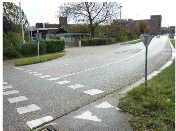
Verkeerd opgestelde driehoek
